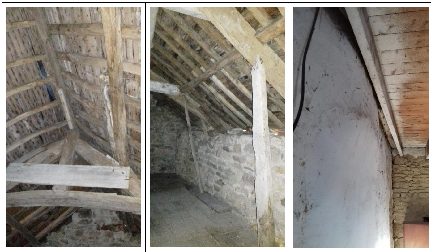
Figure 6. Photos de la charpente en mauvais état de la maison du n°26
